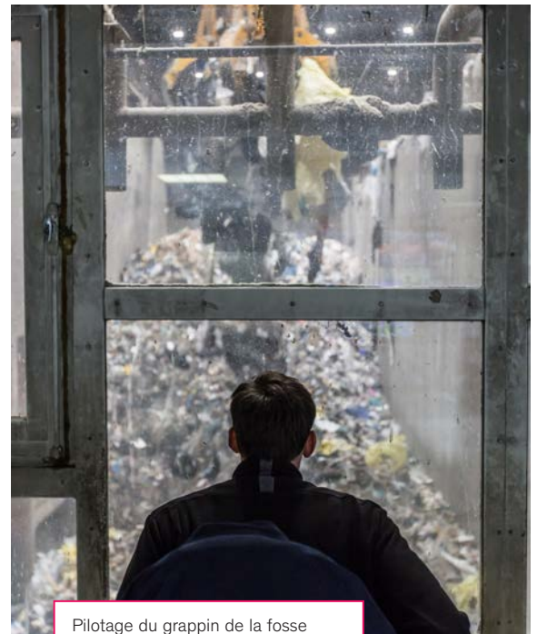
Pilotage du grappin de la fosse depuis la salle de contrôle Athanor.
